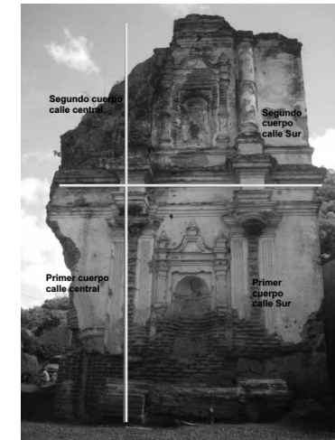
Figura 4. Estado de la fachada (Fotografía y edición: I. Zeceña 2014).
